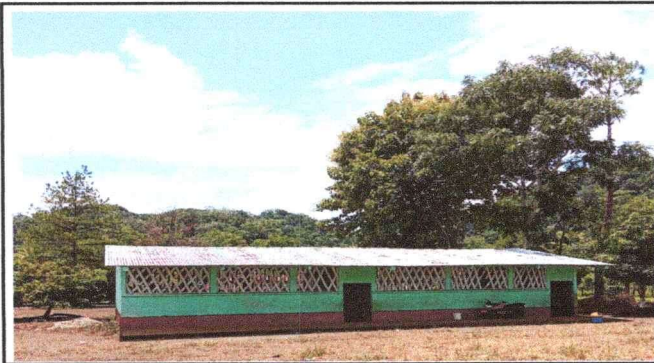
Foto1: Se observa el techo en mal estado, necesita ser remozado
