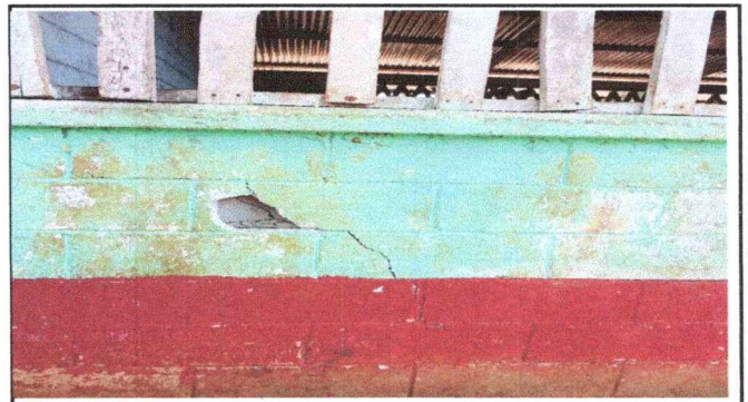
Foto 4: se observa el estado de la pared con grietas necesita ser remozado.
