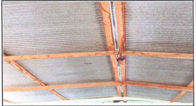
Foto 2: se observa las tijeras del techo del establecimiento en mal estado necesita ser remozado
