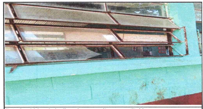
Foto 6: vidrios de la direccion necesita ser sustituido
